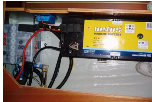
Das Bild zeigt Starter - (weiß) und eine der Bordbatterien (schwarz) unter der Steuerbordsitzbank. Eine zweite Bordbatterie ist aus Gewichtsgründen an Backbord. Unten links im Bild der Shunt zum Messen des Stroms.
