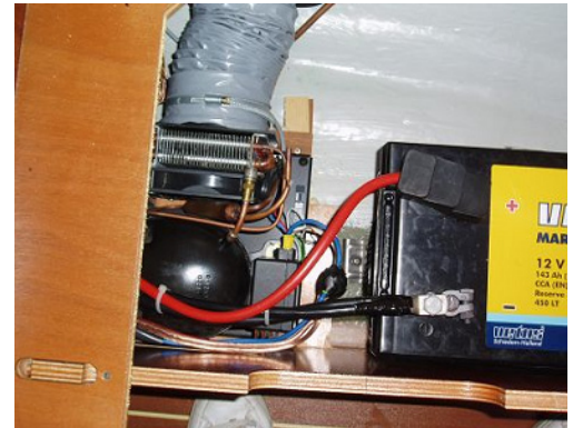
Der Kompressor ist unter einer Sitzbank eingebaut. Mit dem grauen Schlauch wird die warme Abluft auf die andere Seite des Schrankes geführt um einen thermischen Kurzschluss zu vermeiden.
