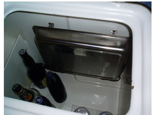
Durch diese Speicherplatte läuft der Kompressor nur ein paar mal am Tag. Dann allerdings für mindestens eine halbe Stunde. Allein durch Vermeidung des ständigen Neuanlaufes wird viel Energie gespart.
