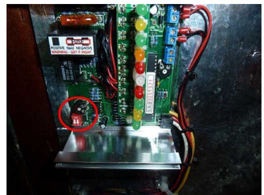
Mit diesem Trimpotentiometer (unten links, direkt über den Schaltern für die Batterieauswahl) lässt sich die max. Ladespannung einstellen. Drehen im Uhrzeigersinn führt zu höheren Spannungen.
