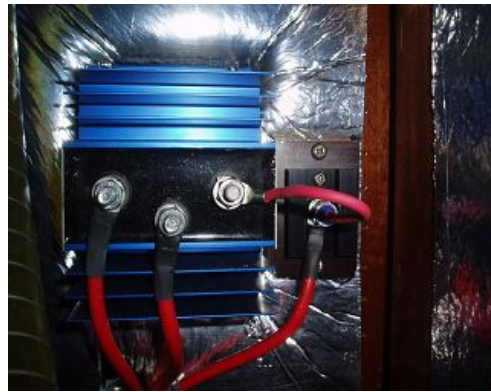
In Reihe geschaltete Zusatzdioden für die Starterbatterie neben dem standardmäßig vorhandenen Diodenblock.
